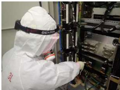
不要直流負荷の切離し操作 (安全系計装盤室) (原子炉補助建屋 T. P. 17. 8m)
