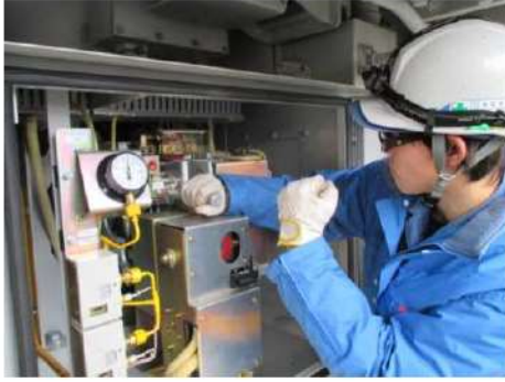
開閉所設備遮断器操作 (屋外 T.P. 85m)
