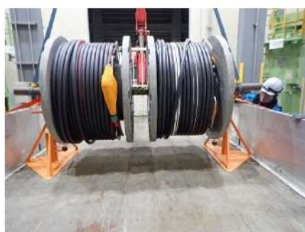
号炉間連絡予備ケーブル
