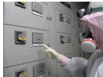
ディーゼル発電機燃料油移送ポンプ 起動操作 (ディーゼル発電機制御盤室) (原子炉建屋T. P. 10. 3m)
