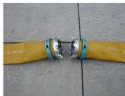
可搬型ホース（150A）接続前
