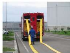
ホース延長・回収車（送水車用）による 可搬型ホース敷設 (屋外 T.P. 10.3m)
