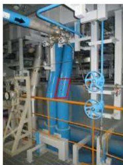
可搬型温度計測装置（格納容器再循環ユニット入口温度／出口温度）設置場所（供給側） （原子炉建屋 T. P. 14. 3m）
