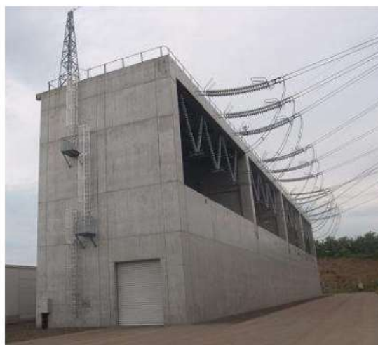
図1 開閉所（遮風建屋）
