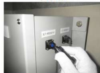
ケーブル接続 BOX
