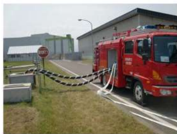
可搬型大型送水ポンプ車の設置 代替給水ビットへの吸管挿入 (屋外 T. P. 33. 1m) (作業風景は類似作業)
