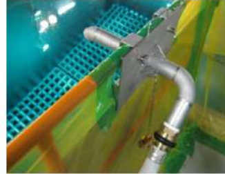
消防ホース接続 (原子炉建屋 T. P. 33. 1m)
