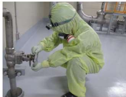
2次系補給水ポンプによる注水 (原子炉建屋 T.P. 14. 9m)
