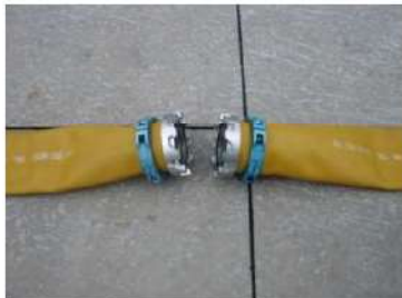
可搬型ホース (150A) 接続口
