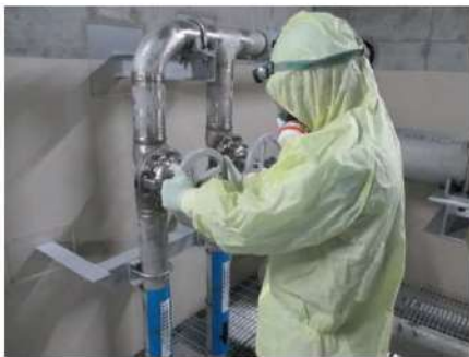
2次系補給水ポンプによる 注水系統構成 (原子炉建屋 T.P. 14. 9m)
