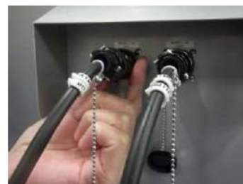
検出器用ケーブル接続
