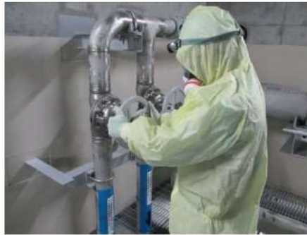
燃料取替用水ポンプによる注水系統構成 (原子炉建屋 T.P. 14.9m)
