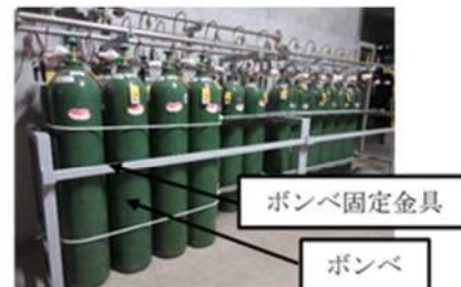
【3号機タービン建屋】 液化炭酸ガス (発電機水素置換用)
