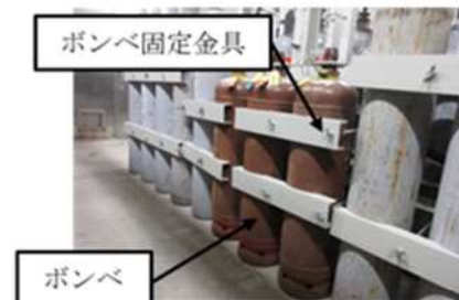
【3号機1次系窒素ボンベ庫】 アセチレン (分析用)
