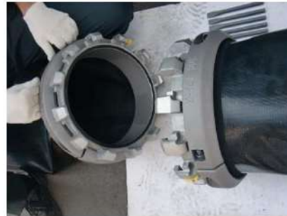
可搬型ホース(300A)接続口
