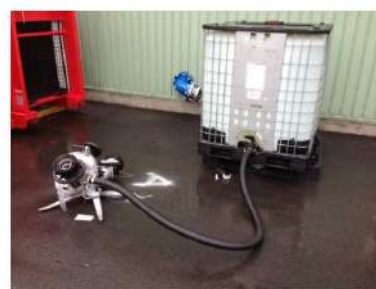
小型放水砲及び泡消火薬剤
