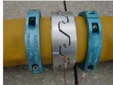
可搬型ホース (150A) 接続後
