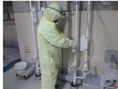
窒素供給操作 (系統側バルブ操作) (原子炉建屋 T. P. 40. 3m)
