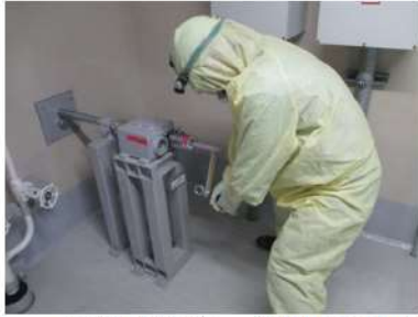
アンモニア排気ダンパ現場手動操作 (原子炉建屋 T. P. 40. 3m)
