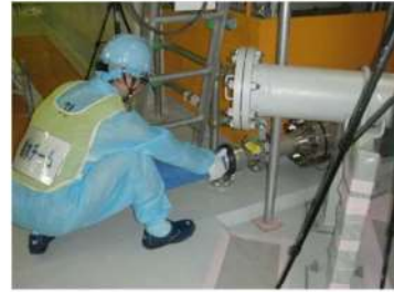
可搬型ホース敷設 (原子炉建屋 T. P. 28. 9m)
