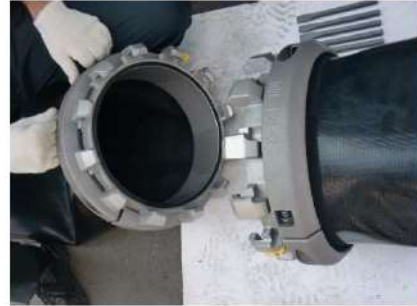
可搬型ホース（300A）接続
