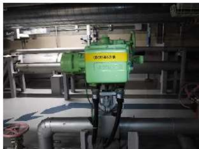
【図1 3A-1次冷却材ポンプ封水注入ラインC/V外側隔離弁】
