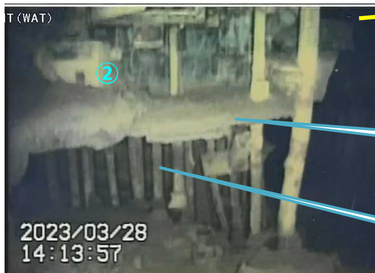
写真2.ペDESTAL開口部左下側壁面部
