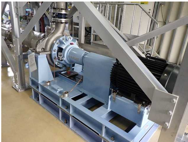
循環ポンプ設置の状況
