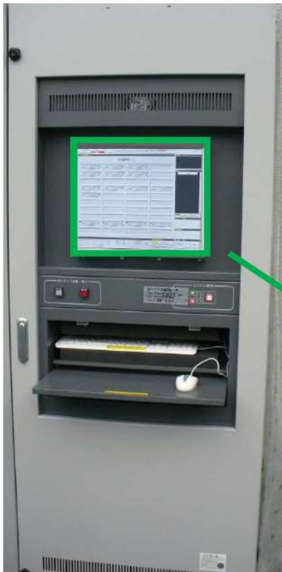
写真④ 中央制御室 総合操作盤
