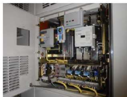
パワーコントロールセンタ
