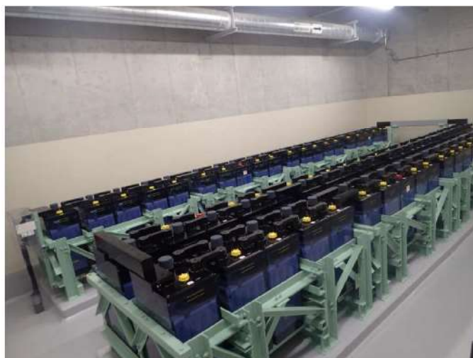
第 1-27 図：安全系蓄電池室の状況
