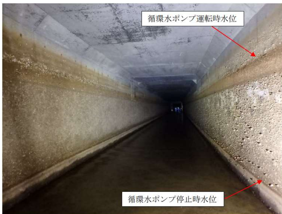
写真2 1号炉放水路（2023年2月）
