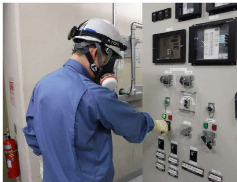
制御棒駆動装置用電源出力遮断器開放 （原子炉建屋 T. P. 17. 8m）
