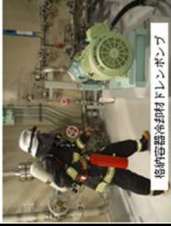
格納容器冷却材ドレンポンプ ⑤消火栓による消火
