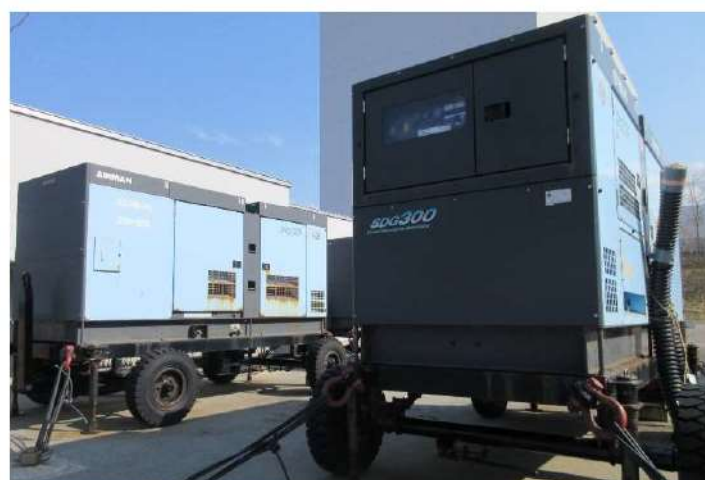
図4-11 緊急時対策所用発電機 外観
