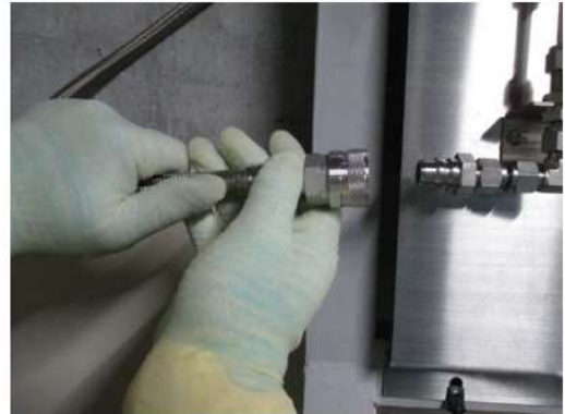
アニュラス全量排気弁操作用可搬型 窒素ガスポンベのカップラ接続 (原子炉補助建屋 T.P. 40. 3m)
