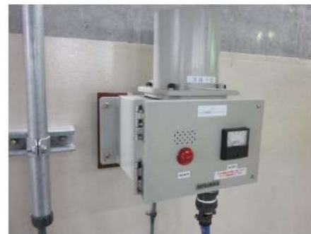
機器の固定状況
