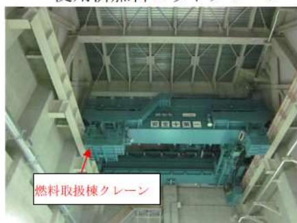
燃料取扱棟クレーン
