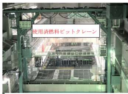
使用済燃料ピットクレーン
