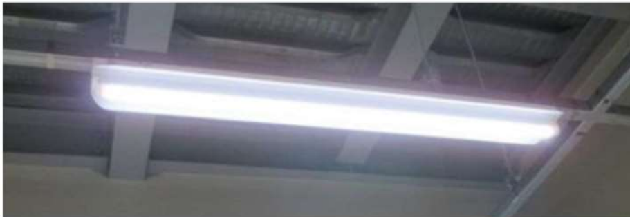
無停電運転保安灯
