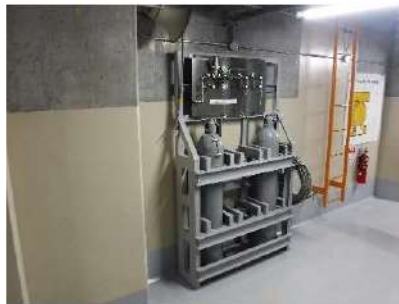
【図1 アニュラス全量排気弁操作用可搬型窒素ガスポンペ】
