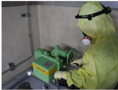
【図3 3B-1次冷却材ポンプ封水注入ラインC/V外側隔離弁操作風景】
