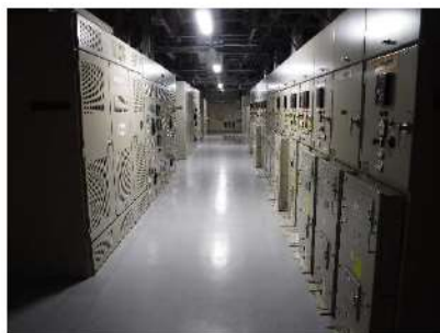
【図1 3B-安全補機開閉器室】
