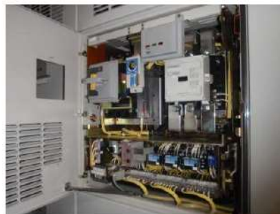
パワーコントロールセンタ
