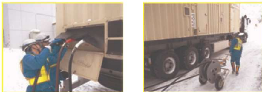
図2 可搬型代替電源車設置訓練
