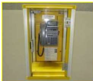
運転指令設備（警報装置を含む）
