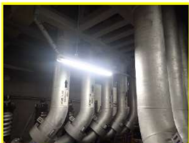
図 15 無停電運転保安灯
