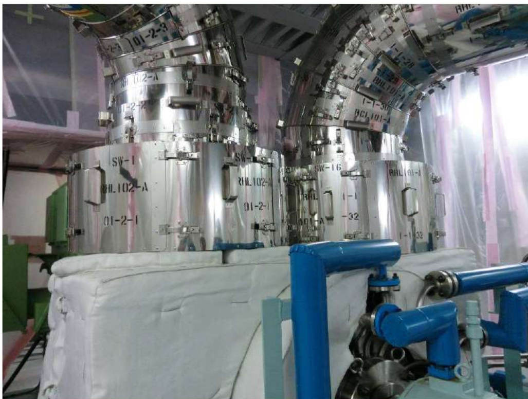
余熱除去ポンプ 配管周辺部
