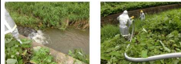
図2-27 消防自動車による予防散水
