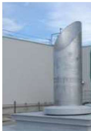
図3 主蒸気安全弁（排気管）の設置状況
