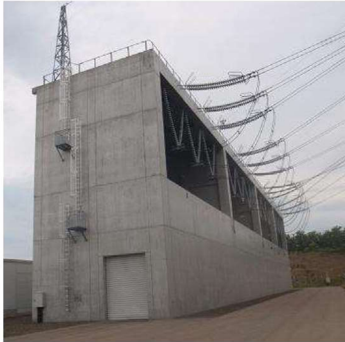
図1 開閉所（遮風建屋）
