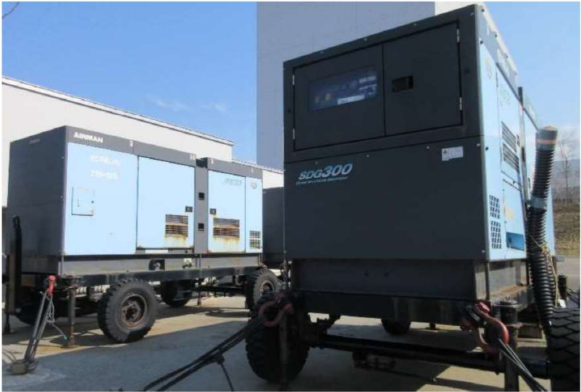
図 4-11 緊急時対策所用発電機 外観
