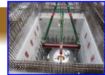
フィルタ付ベント装置据付 (2015(H27)年7月31日)
