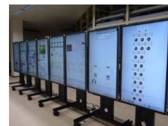
2号機 SA設備操作盤
