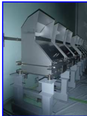
原子炉建屋 可燃性ガス再結合器
