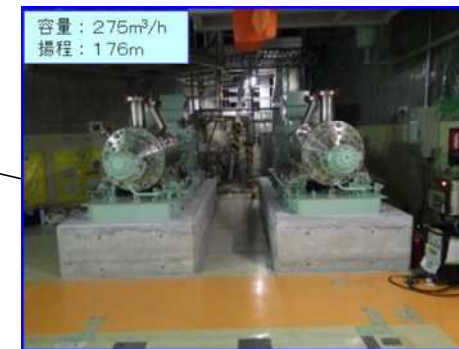
常設代替低圧ポンプ
