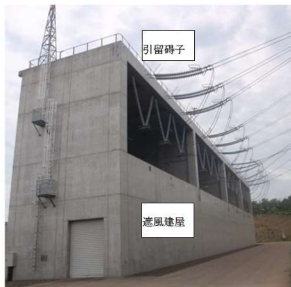
第 5.1 図 275kV 架線部 (引留碍子)
