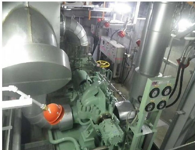
図27-2 4タービン動補助給水ポンプ 外観
