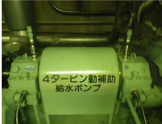
図27-1 4タービン動補助給水ポンプ 機器名表示
