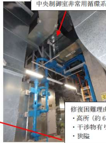
中央制御室非常用循環系統ダクト
