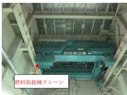
燃料取扱棟クレーン
