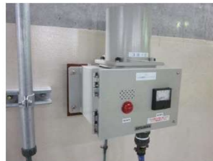
機器の固定状況
