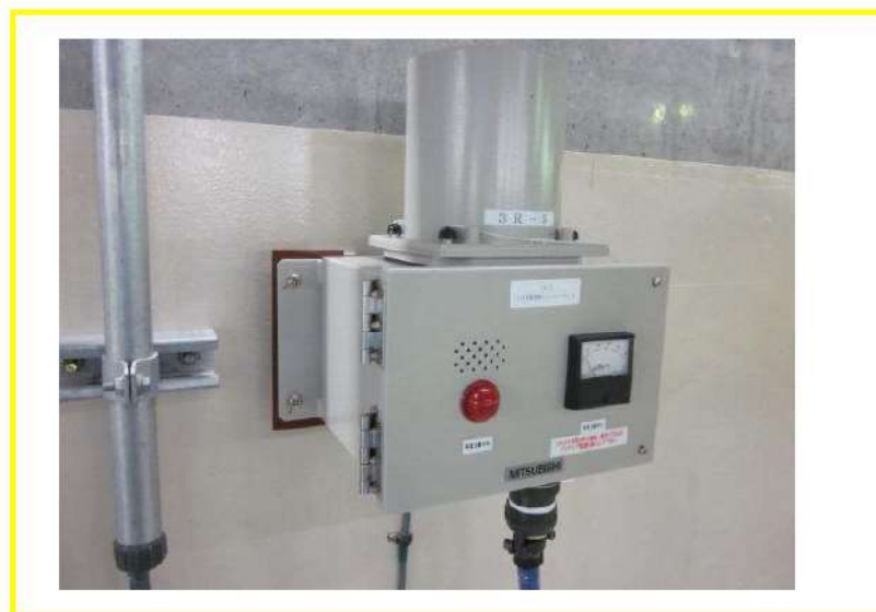
図2 機器のボルトによる壁面固定
