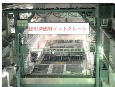
使用済燃料ピットクレーン
