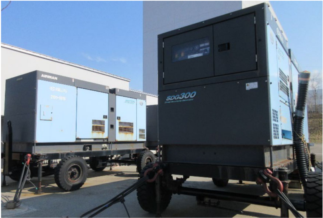
図 4-11 緊急時対策所用発電機 外観
