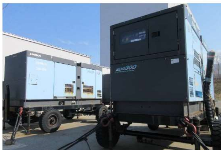
図4-11 緊急時対策所用発電機 外観
