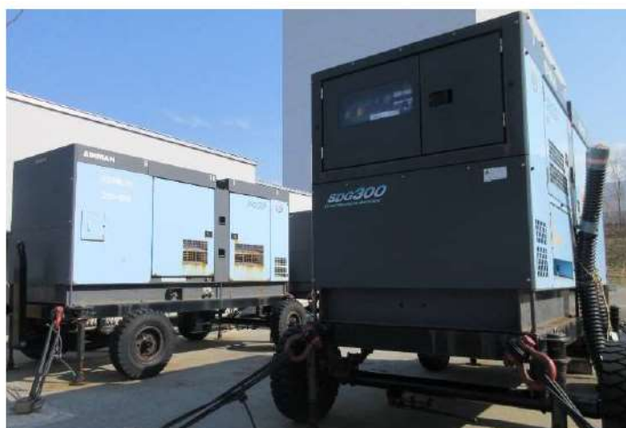
図4-11 緊急時対策所用発電機 外観
