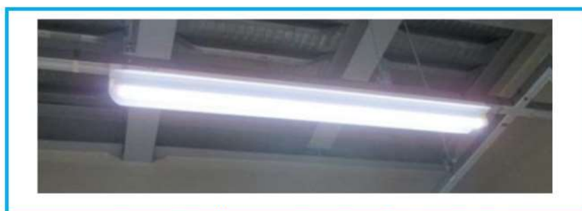
緊急時対策所照明（バッテリー内蔵LEDランプ）
