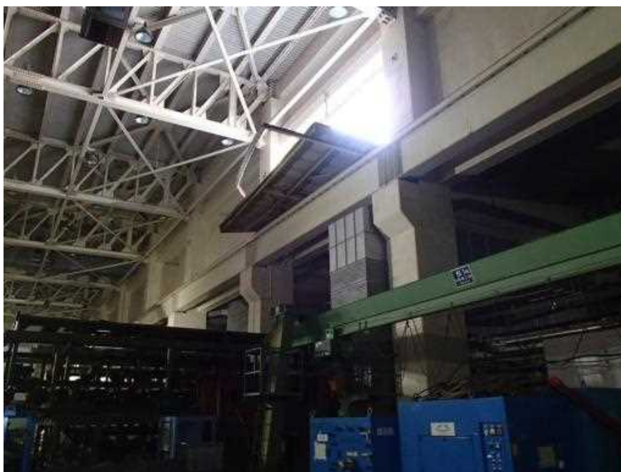
写真①：BOP損壊部分（塞ぎ前、屋内）
