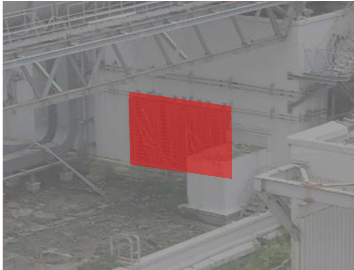
参考写真：雨水侵入箇所
