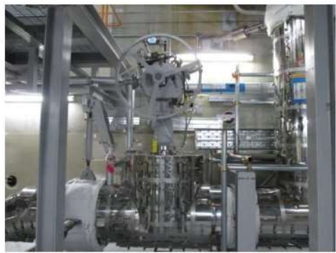
3 A-余熱除去ポンプ入口弁 (3V-RH-005A)
