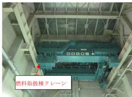
燃料取扱棟クレーン
