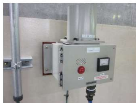
機器の固定状況
