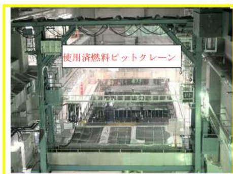
使用済燃料ピットクレーン
