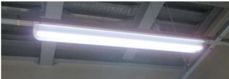
無停電運転保安灯
