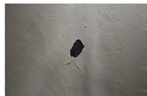
判定フロー③と判断した塗膜の劣化（2号炉）
