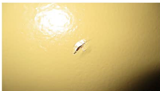
判定フロー②と判断した塗膜の劣化（1号炉）
