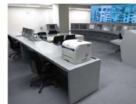
通常点灯時 (中央制御室非常用照明及び非常用照明)
