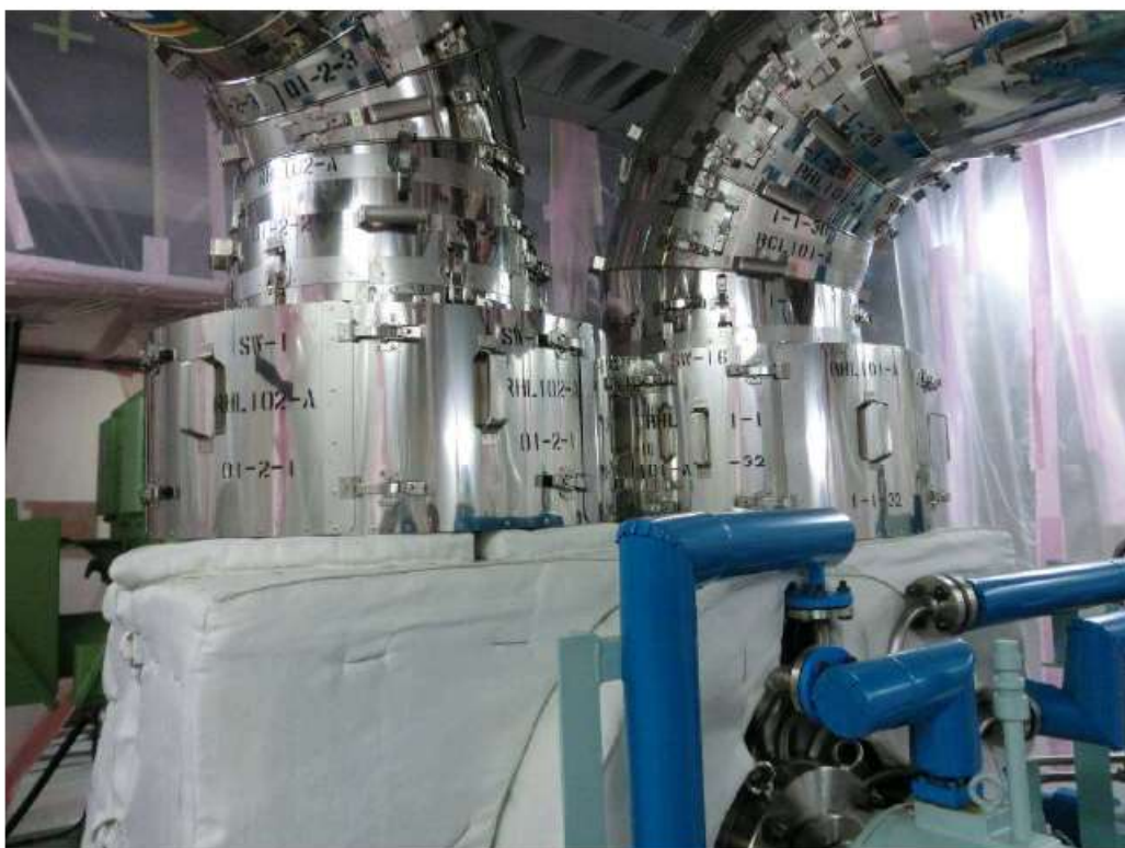
余熱除去ポンプ 配管周辺部
