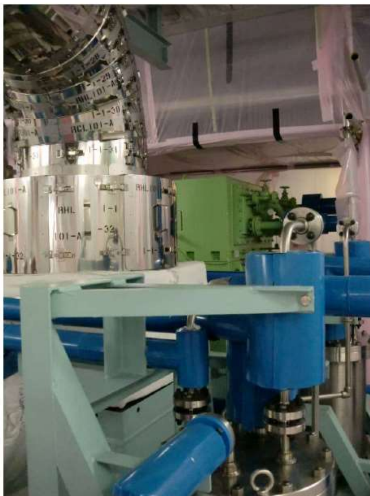
余熱除去ポンプ 外観
