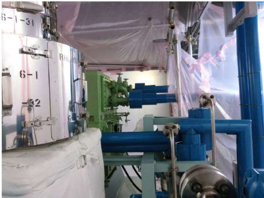
余熱除去ポンプ 周辺状況
