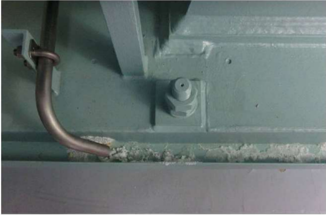
余熱除去ポンプ 据付部
