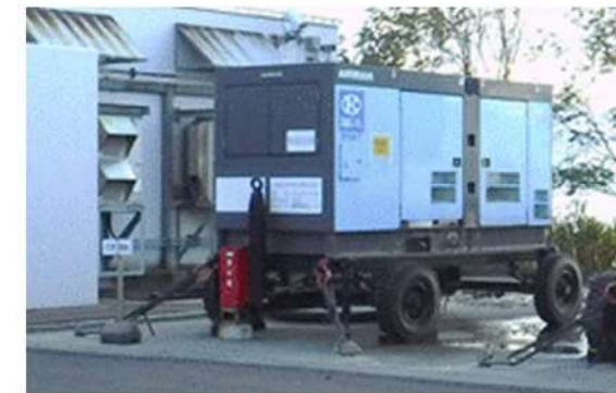
緊急時対策所用発電機
