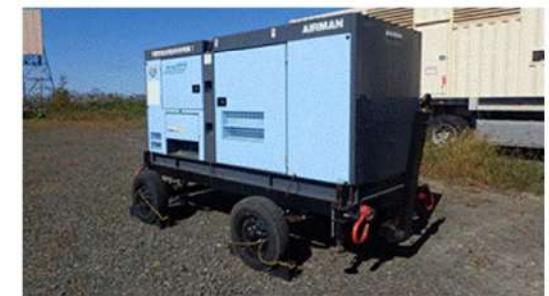
可搬型直流電源用発電機
