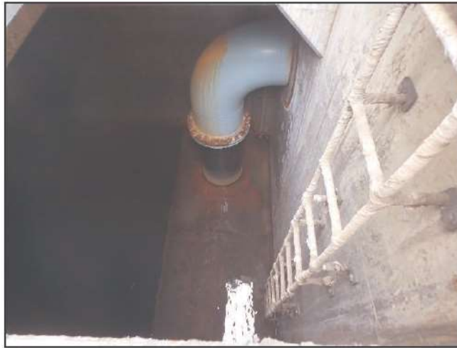
【原子炉補機冷却海水放水ピットの写真】
