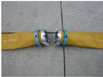
可搬型ホース(150A)接続口
