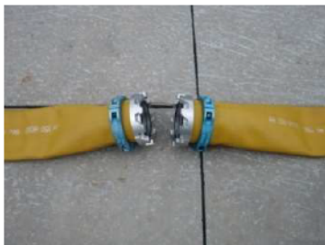
可搬型ホース(150A)接続口
