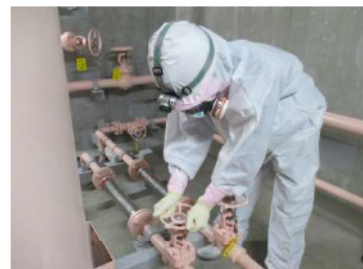
燃料汲み上げ系統構成 (ディーゼル発電機燃料油サービスタンク室) (原子炉建屋 T.P.17.8m)
