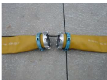
可搬型ホース(150A)接続口
