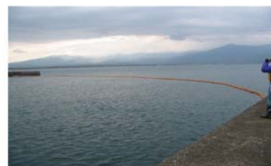
間口部シルトフェンス 設置状況
