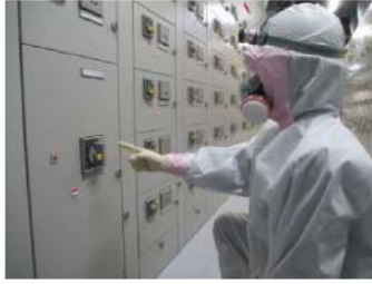
ディーゼル発電機燃料油移送ポンプ 受電準備 (安全補機開閉器室) (原子炉補助建屋 T. P. 10. 3m)
