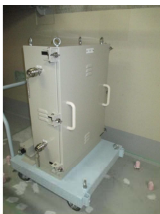
可搬型アニュラス水素濃度計測ユニット （原子炉建屋 T.P. 24. 8m）
