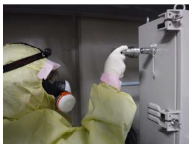
可搬型アニュラス水素濃度計測ユニットの接続 （原子炉建屋 T.P. 24. 8m）
