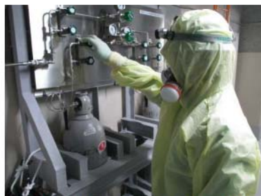
窒素供給操作(バルブパネル操作) (原子炉補助建屋 T.P. 40. 3m)
