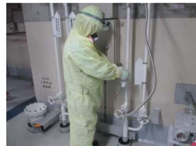
窒素供給操作(系統側バルブ操作) (原子炉補助建屋 T.P. 40. 3m)
