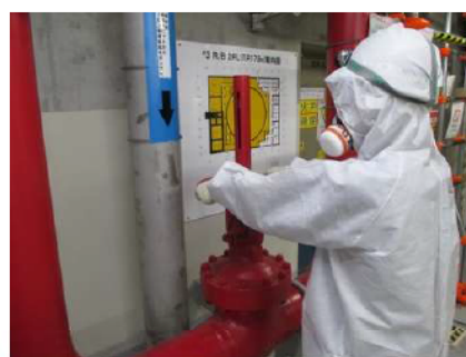
消火水注水系統構成 （運転員（現場）②） （原子炉建屋 T.P. 17. 8m）
