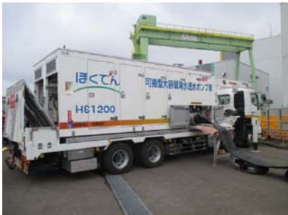
可搬型大容量海水送水ポンプ車の設置 (屋外 T.P. 10m)
