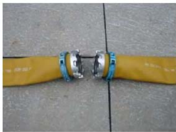
可搬型ホース (150A) 接続口
