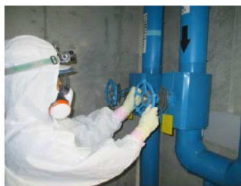
補機冷却水（海水） 通水系統構成 （運転員（現場）②） （原子炉建屋 T. P. 10.3m）
