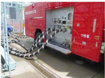
可搬型大型送水ポンプ車の設置 ポンプ車周辺のホース敷設 (屋外 T. P. 10m)
