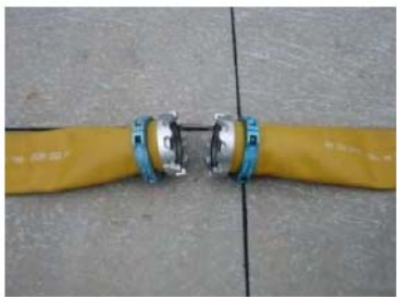
可搬型ホース (150A) 接続口
