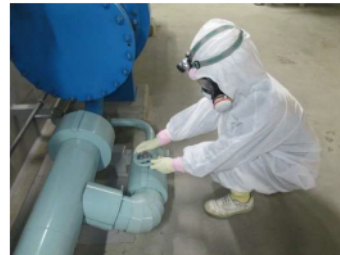
海水系統水抜き (原子炉建屋 T. P. 2. 8m)
