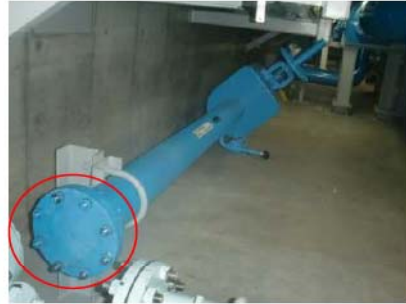
原子炉補機冷却水系統の 可搬型ホース接続口 (原子炉建屋 T. P. 2. 3m)
