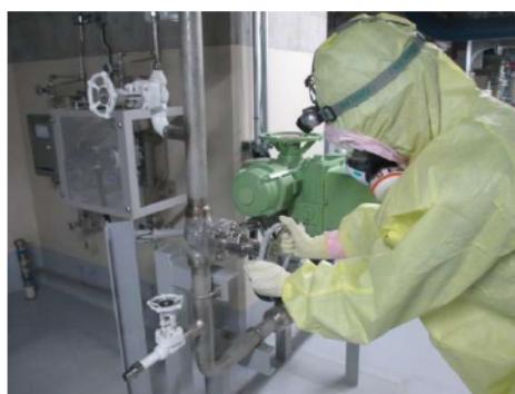
加圧器逃がし弁 代替制御用空気供給操作 (原子炉建屋 T.P. 17. 8m)
