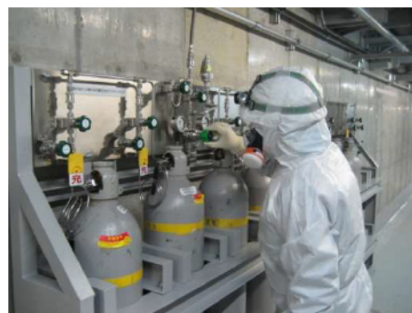
主蒸気逃がし弁 代替制御用空気供給操作 (原子炉建屋 T.P. 10. 3m)
